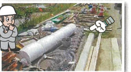
工事資材等の整理整頓がされていない。
