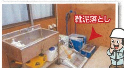
現場事務所に靴の泥落としが設置されていて、現場事務所周辺も綺麗だった。
